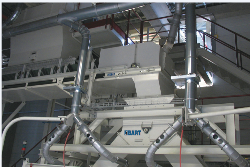
FOT. 1 Filtracja pyłów chemicznych
