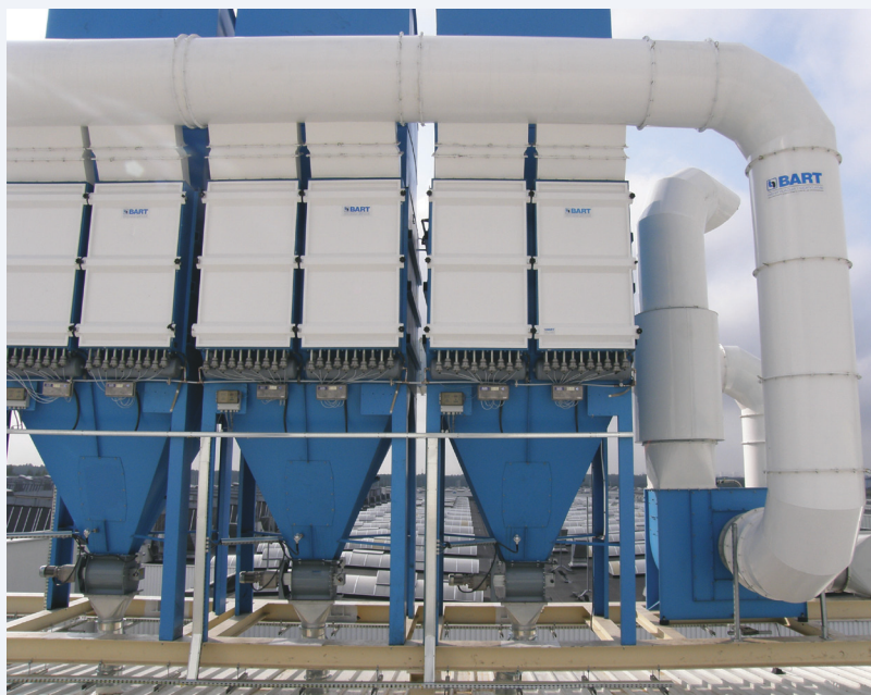
FOT. 4 Filtracja pyłów chemicznych
