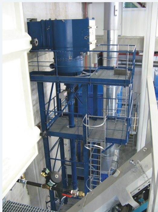
FOT. 2 Instalacja centralnego odkurzania
